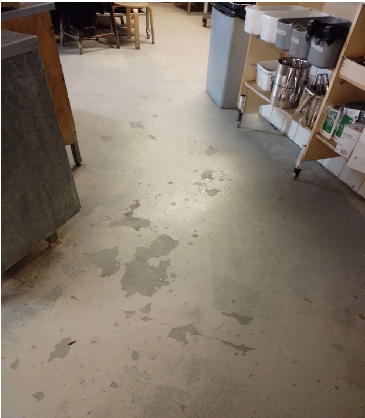
Keittiötiloissa lattiapinta kulunut ja epätasainen.
